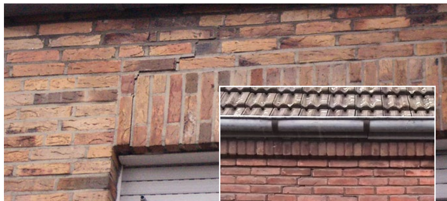
Schäden mit identischem Schadensbild gibt es auch in Gebieten, die nicht vom Bergbau beeinflusst sind. Beispiel Fensterstürze: Das Bild rechts zeigt einen Bauschaden aus Wesel, das Bild oben einen Bergschaden aus Alt-Büderich vor der Sanierung von Cavity. Grundsätzlich gilt: Man muss die Messdaten und die Bodenbewegungen kennen, um eine fundierte Aussage treffen zu können, ob ein Schaden vom ehemaligen Salzbergbau verursacht wurde.
